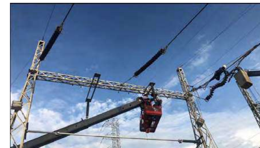
Ilustración 2 Subestación Ternera 66kV Separación fases
