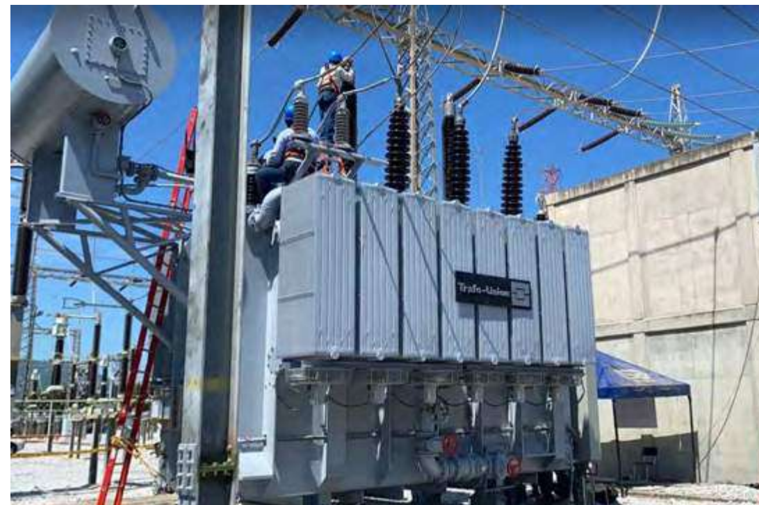
Ilustración 3 Transformador Santa Marta 2 220/110/34.5kV
