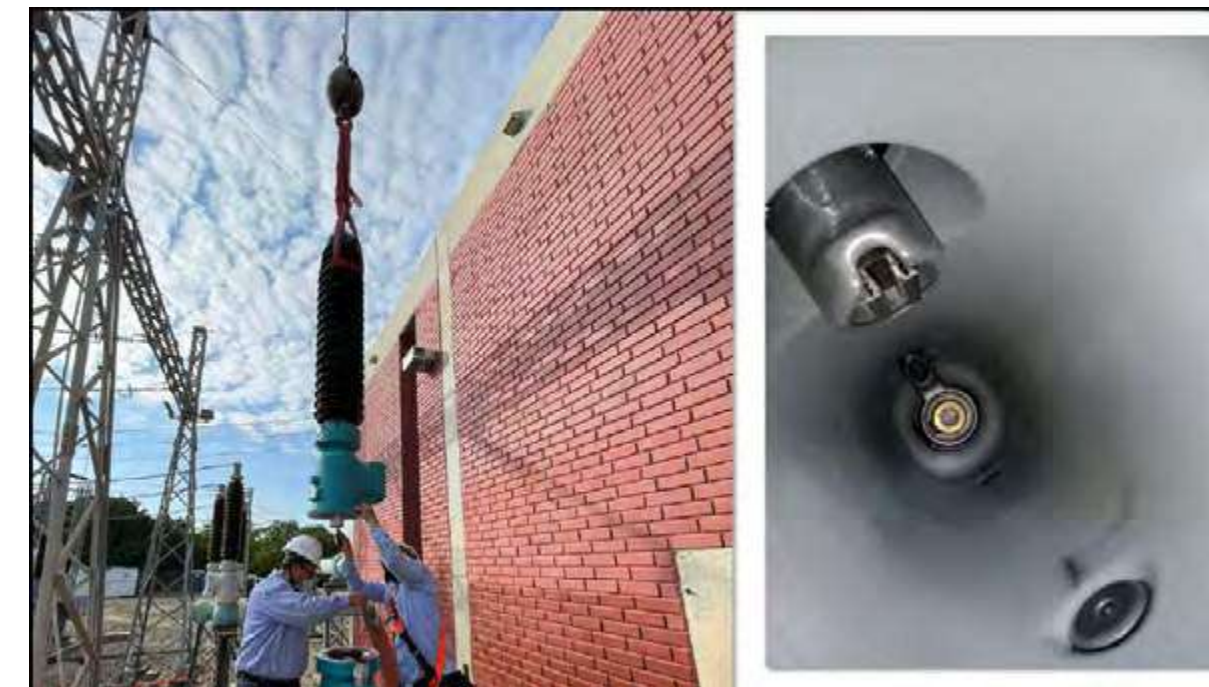
Ilustración 5 Subestación Termocartagena 66 kV
