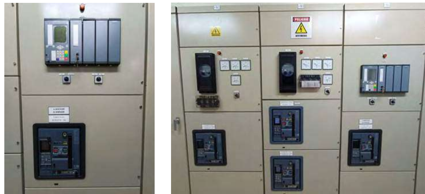
Ilustración 4 Breakeres de alimentación de 220VAC subestación Nueva Barranquilla
