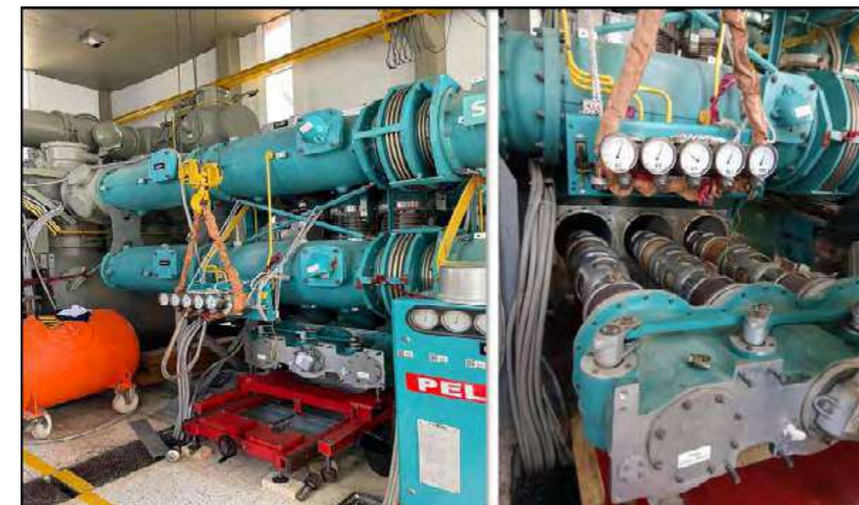
Ilustración 6 Subestación Termocartagena 66 kV
