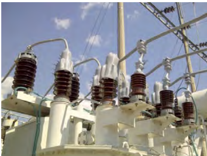
Figura No 1: Elementos de Protección Transformador El Copey 02 34.5/13.8 kV
