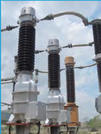
Figura No 8: Nuevos Transformadores de Corriente anillo 66 kV Subestación Ternera
