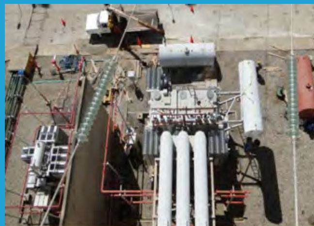
Figura No 4: Vista Superior Nuevo Transformador 200 MVA T-TGJ01.
