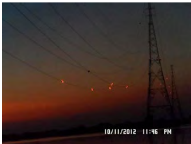
Figura No 11: Vista nocturna nuevas balizas instaladas
