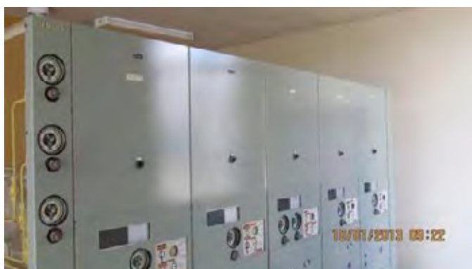
Figura No 2: Intervención de mecanismos Celdas Encapsuladas 8DA10
