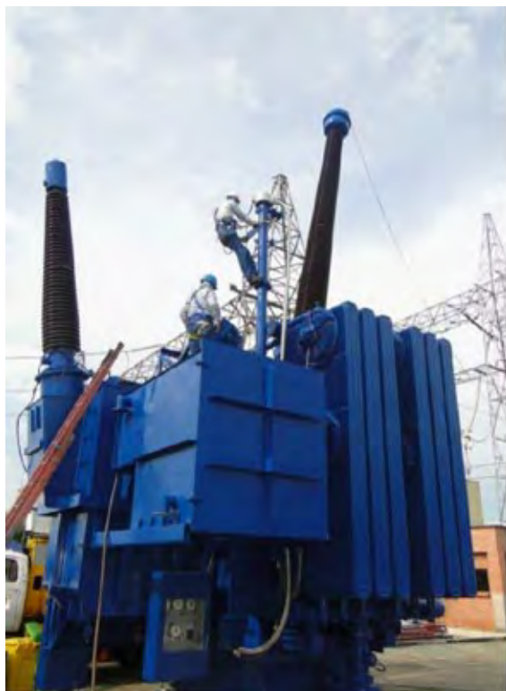
Figura No 13: Unidad de Reserva 150 MVA 500/220/34,5 kV
